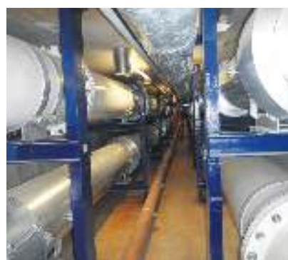
▲ Vuoden 2012 vuosihuoltojen yhteydessä tehtiin mittavia sivumerivesipiirin putkistojen uusintatöitä Loviisa ykkösellä. Yhteensä putkistoja uusittiin noin 810 metriä.
